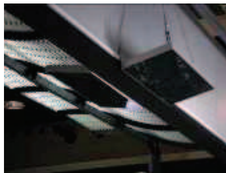
動線管理用アンテナ?(天井取り付け)
